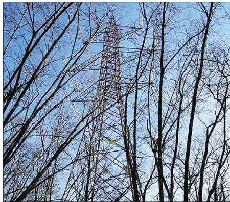
Un traliccio dell'alta tensione sulla collina di Villazzano (foto Giacomoni)
